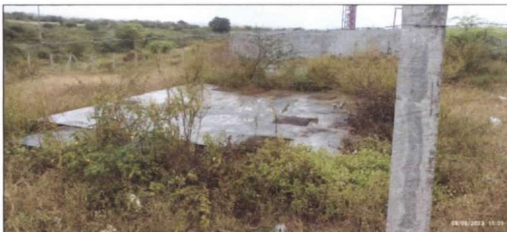
Figura 29 - Sistema individual - Fossa do Povoado de Livramento.
