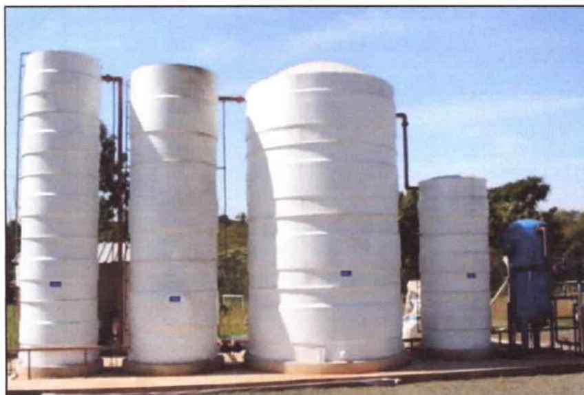
Figura 27 – Estação Compacta de Tratamento de Esgotos Sanitários.
