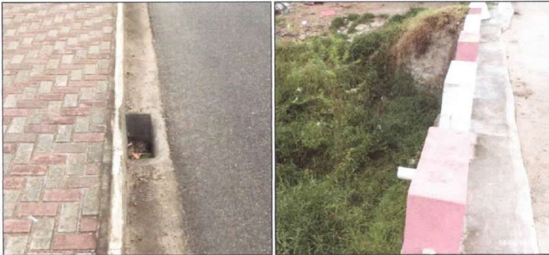
Figura 44 - Dispositivos de microdrenagem no município de Vertentes.
